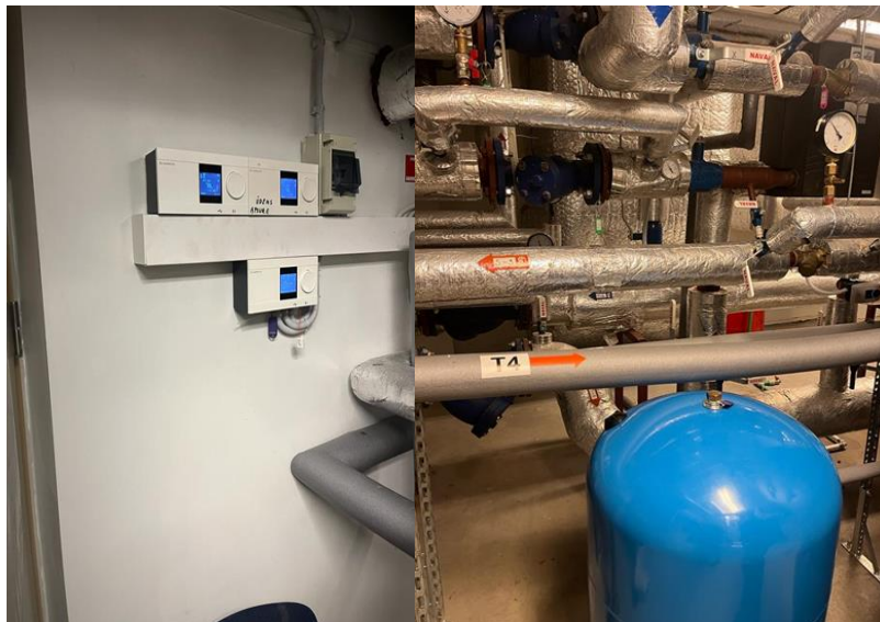
3.9.7. att. Siltummezgla kontroles panelis (pa kreisi) un siltummezgla apsaiete mācību korpusā („Ogres meža tehnikums”, Aizupes, Tīnūžu pagasts) (pa labi).
