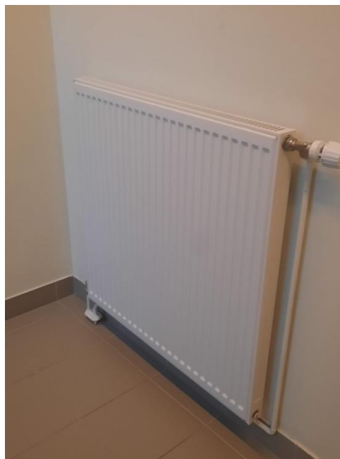
3.4.5. att. Visās apsekotajās ēkās uzstādīti radiatori ar regulatoriem
