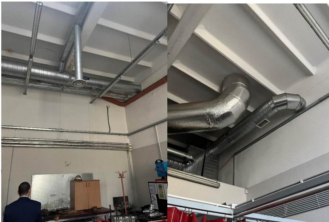
3.6.4. att. Ventilācijas sistēmas gaisa pieplūdes un nosūces kanāli.
