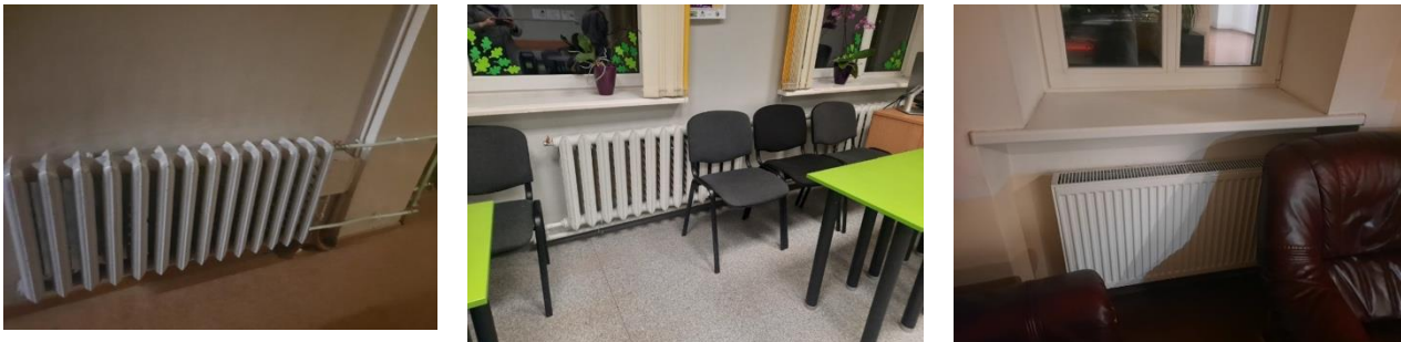
3.3.3. att. Ēkā ir tikai daži sildķermeņi, ko iespējams regulēt. Lielākā daļa apkures sistēmas nav renovēta.
