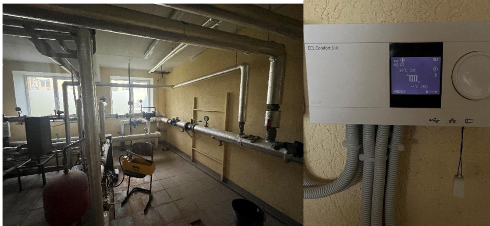
3.6.6. att. Ēkas siltummezgls (pa kreisi) un kontrolpanelis siltummezglā (pa labi).
