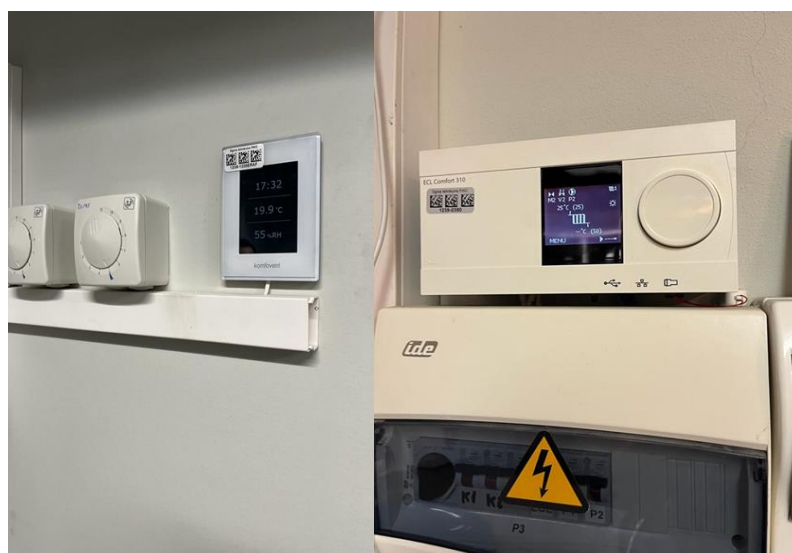
3.9.15. att. Siltummezgla kontroles panelis.
