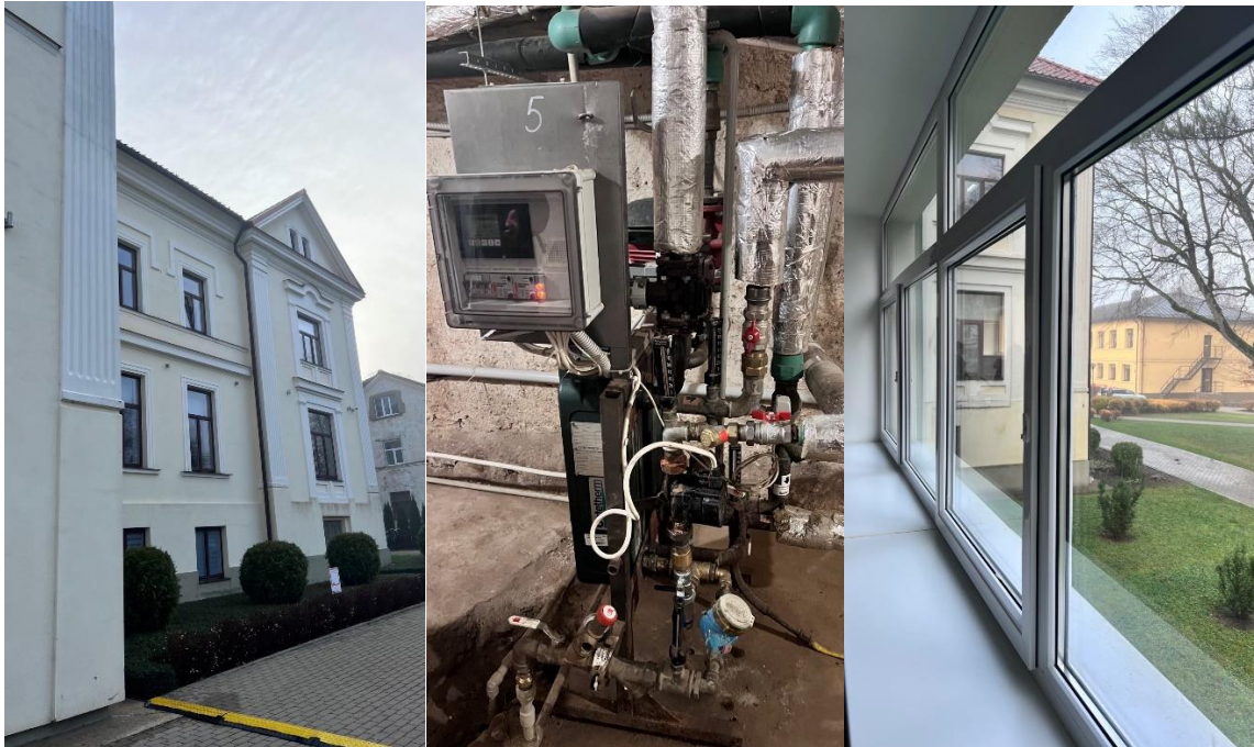
3.17.1. att. Galvenā ēka, ēkas siltummezgls un energoefektīvi logi.
