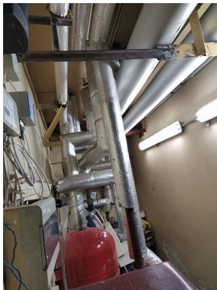
3.2.1. att. Ēkas siltummezgls.
