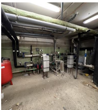
3.10.4. att. Dienesta viesnīcas siltummezgls.
