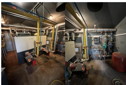
3.10.2. att. Gāzes apkures katls.
