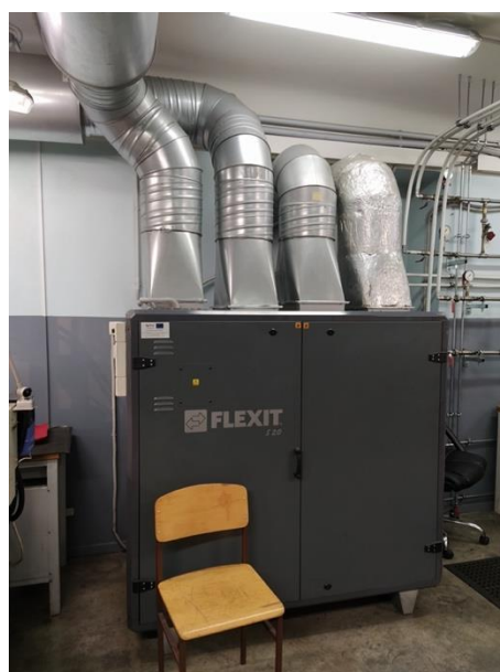
3.2.3. att. Ventilācijas iekārta virpošanas kabinetā.
