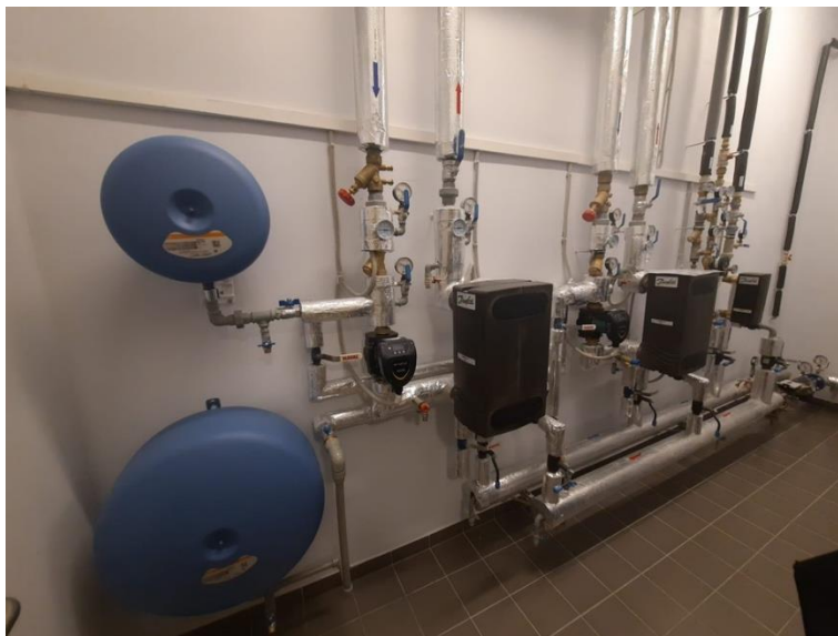
3.4.3. att. Visi siltummezgli renovēti, tiem ir automātiskas regulēšanas iespējas pēc āra gaisa temperatūras.
