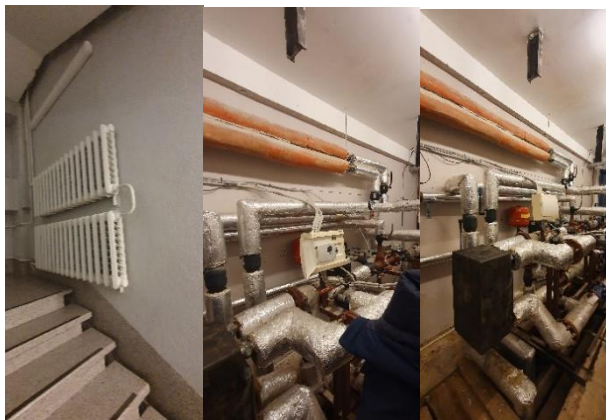
3.22.1. att. Ēkas siltummezgls un apkures sistēma.
