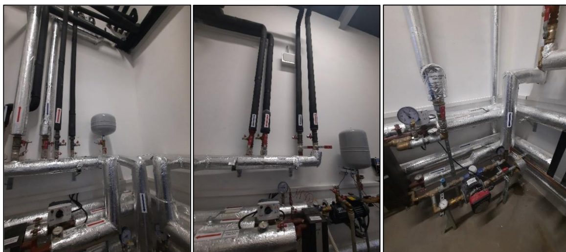
3.20.2. att. Renovētais siltummezgls.
