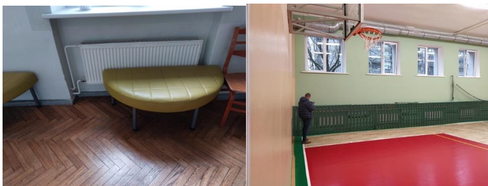
3.1.5. att. RTPV radiators bez siltuma regulēšanas iespējām, nosegti konvektori; telpu vēdināšana, atverot logu, jo ventilācijas sistēma nestrādā augsto izmaksu dēļ.
