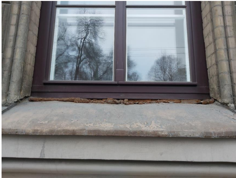
3.8.3. att. Logu iestrāde nav veikta atbilstoši labas prakses standartiem (attēlā nenosegtas siltumizolācijas putas, kas pakļautas āra vides ietekmei – temperatūras svārstības, UV starojums, mitrums)
