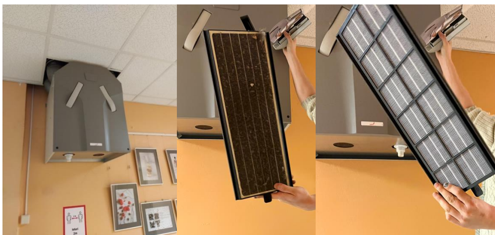
3.23.1. att. Viena no izglītības iestādē uzstādītajām ventilācijas iekārtām darbnīcu korpusā, kas nodrošina vienas mācību telpas ventilāciju, un tajās esošie gaisa filtri.
